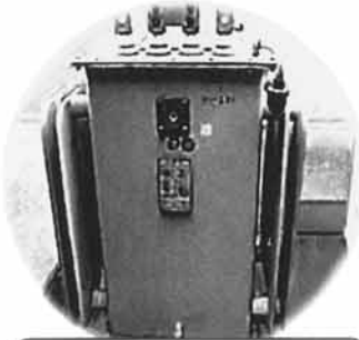
変圧器(トランス)
